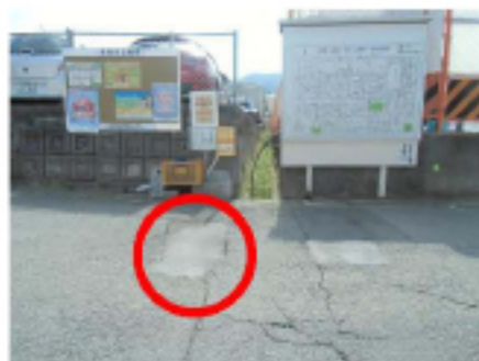
応急処置でへこみ解消。これで安全に通行可能です
